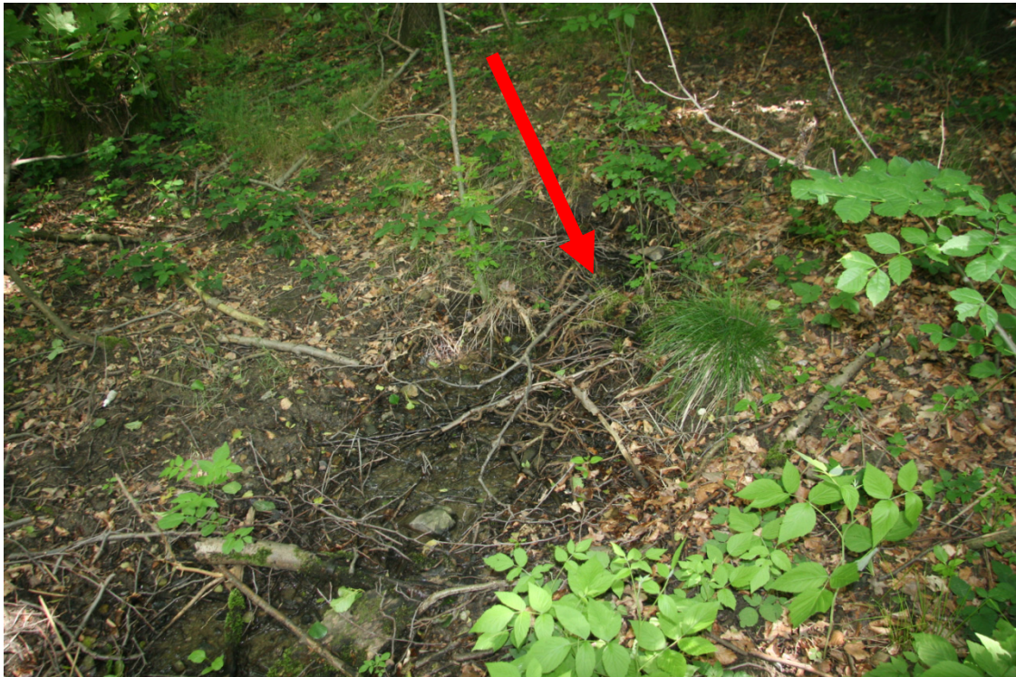
Abb. 6: Sickerstelle am Westdamm der Teiches 1 (04.07.2012)
