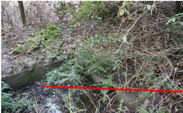
Foto 20: Beginn Meine - Auslauf Rohrleitung
