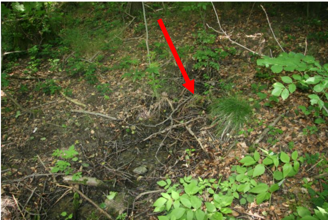
Abb. 9: Sickerstelle am Westdam von „Teich 1“ (04.07.2012)
