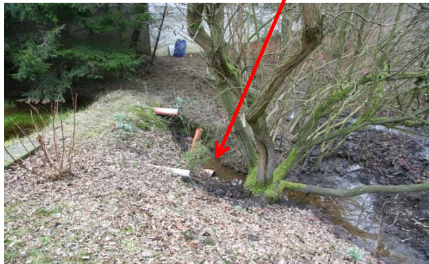
Foto 25: Drainageienläufe neben Meine
