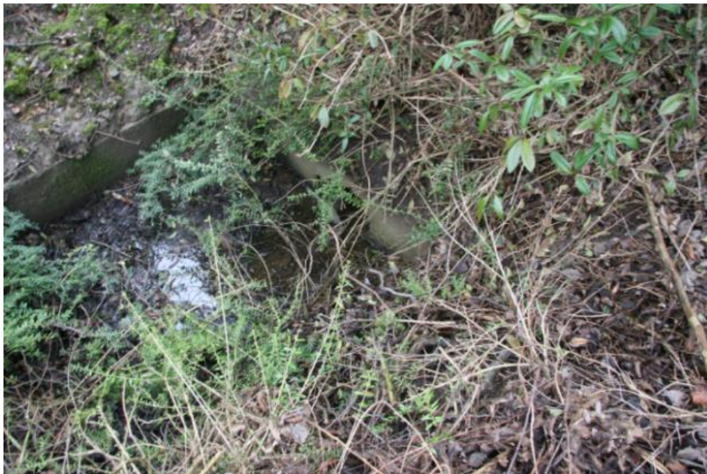
Abb. 8: Auslaufbauwerk mit geringem Abfluss aus der Rohrleitung in den offenen Graben am Südwestrand der MHS am 13.03.2012
