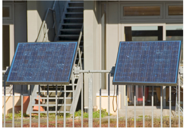
Photovoltaik-Module der Ökostation Bauen und Technik
