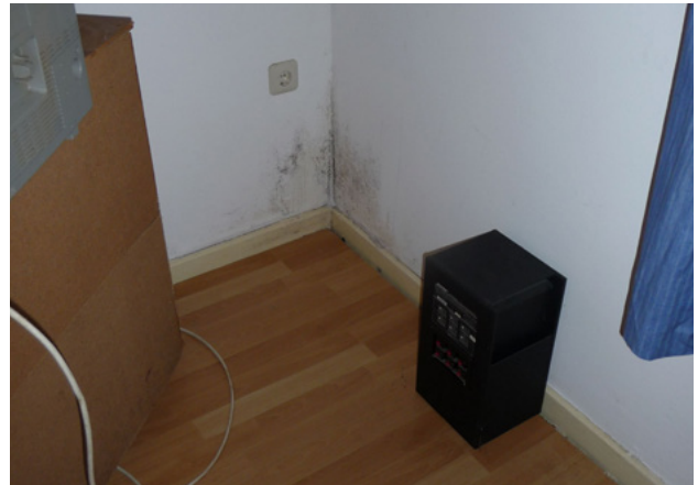
Schimmelbefall durch Wärmebrücke in einer Raumecke.
