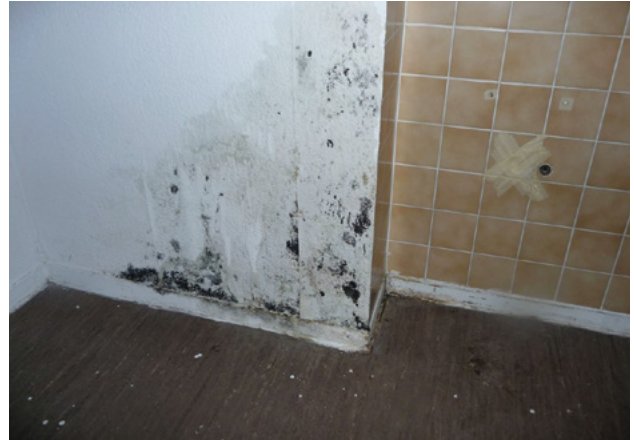
Schimmelbefall auf einer Innenwand (Ursache: defektes Fallrohr)
