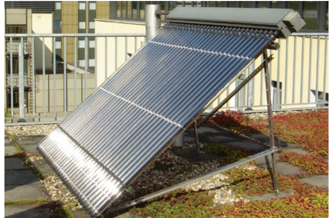
Vakuurröhren-Kollektor der Ökostation Bauen und Technik
