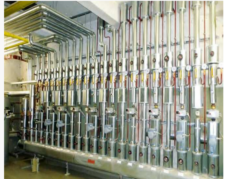
Heizkreisverteiler im Keller einer Schule
