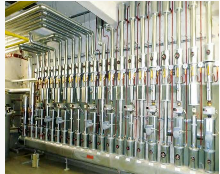
Heizkreisverteiler im Keller einer Schule
