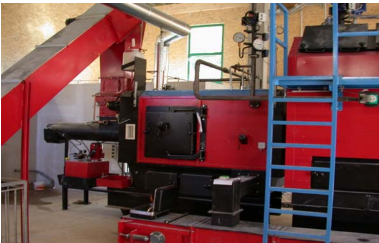
Brenner (links) und Kessel der Holzhackschnitzelheizung mit Teilen der Hackschnitzelzuführung über eine Kratzkettenförderung und hydraulischen Stempel für die Zuführung der Hackschnitzel in den Brennraum.
