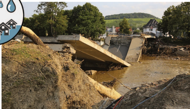
Zerstörte Brücke im Ahrtal.
