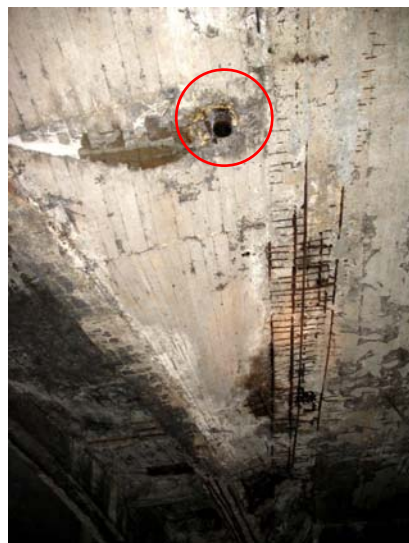
Foto 8: Decke mit Abwassereinfluss
